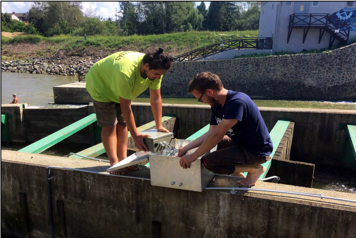
6. kép. Akkumulátor cseréje a szentgotthárdi jelfogó berendezésnél
