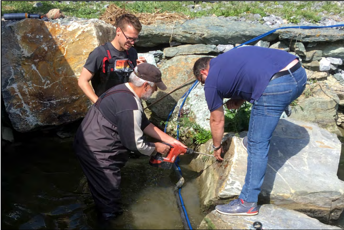
5. kép. Jelfogó antenna telepítése az ikervári halcsatorna legfelső szakaszán
