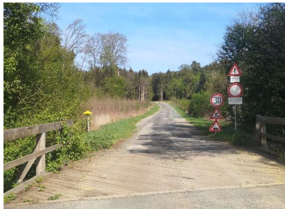
Erhebliche Belagsschäden entlang der alten Bundesstraße
