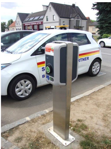
Abb. 9. Elektroladestation beim Kindergarten (Quelle: eigenes Foto)
