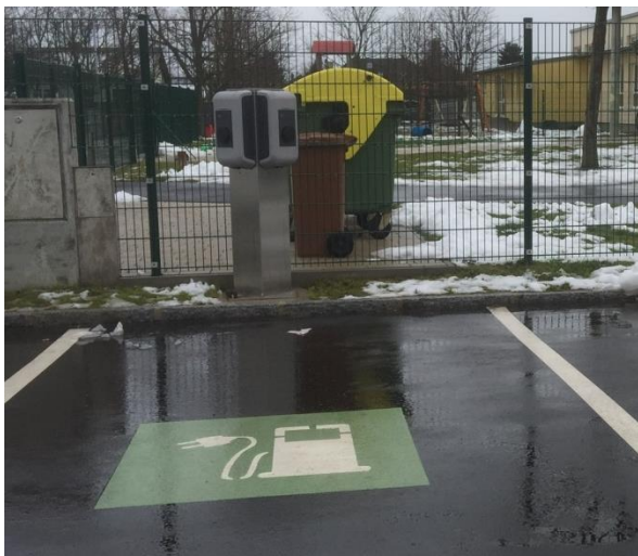
Abb. 7: Elektrotankstelle Deutsch Jahrndorf (Quelle: eigenes Foto)
