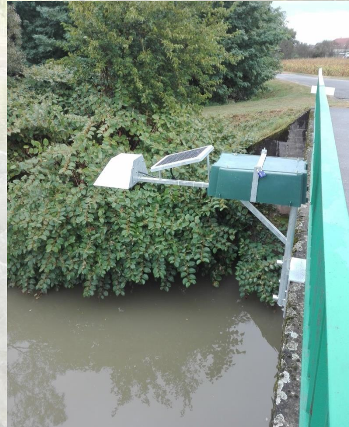
Radaros ultrahangos vízszintmérő állomások (új 7db)
